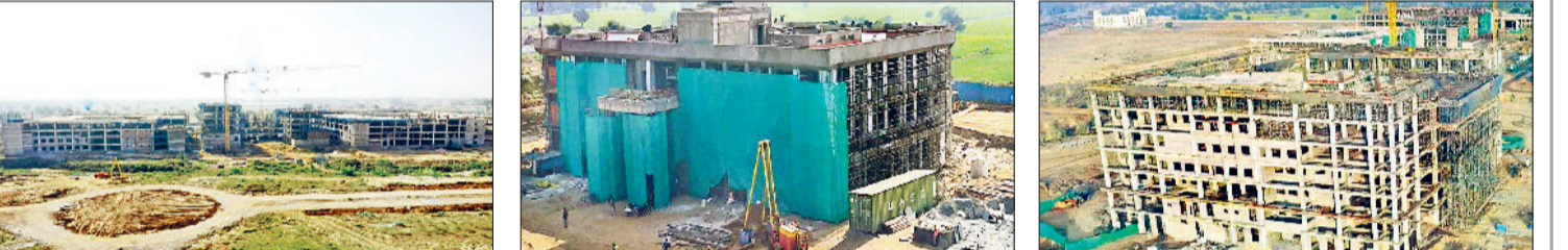
रेवाड़ी। माजरा एम्स की निर्माणाधीन बिल्डिंग व नर्सिंग कॉलेज के लिए तैयार हो रही बिल्डिंग व एम्स का निर्माणाधीन शैक्षणिक ब्लॉक।
